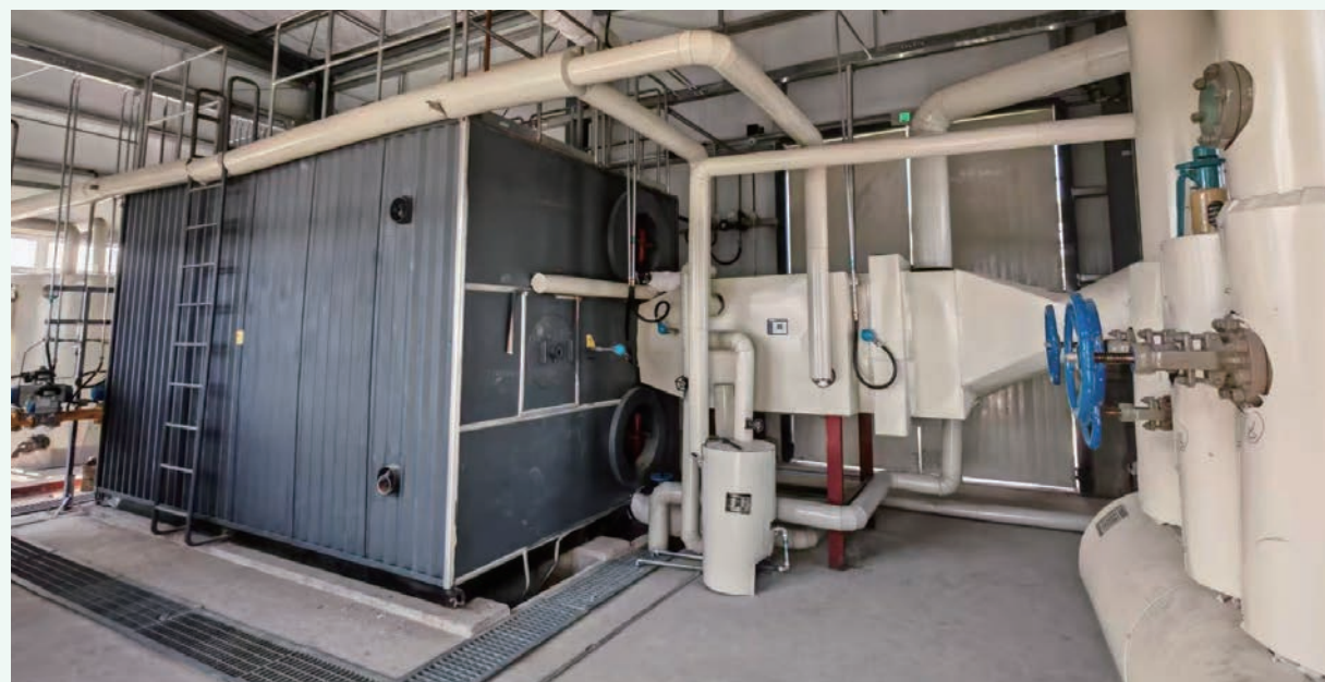
◎ 海华科技2,3,6-三甲基苯酚装置尾气燃烧及余热回收综合利用装置
